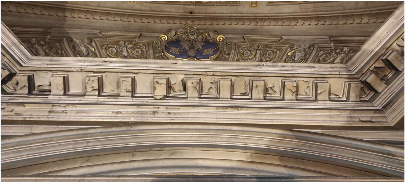
Part cornice con distacchi
